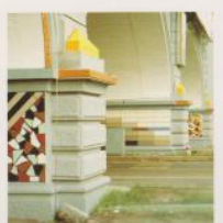
Il rivestimento e l'isolamento del ponte ferroviario situato lungo la direttrice Milano Bergamo. L'acqua ha causato un significativo deterioramento.
