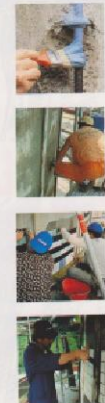
Dall'alto in basso, le fasi dell'intervento: foto 1, applicazione di MAPEFER; foto 2, riporto di MAPEGROFILT TISSOTROPICO; foto 3, posa con KERACOLOR più ISOLASTIC; foto 4, stuccatura con MAPECOLOR.
