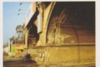
Particolare dell'intervento dal quale viene evidenziato lo stato di degrado del rivestimento dell'acqua prima dell'intervento.
